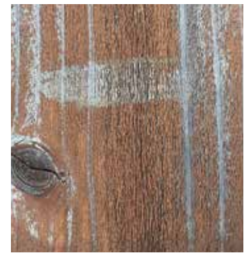
研磨処理 木材の劣化により表面が細かくひび割れ ておりテープで剥離すると着色層が剥 がれてしまった。
